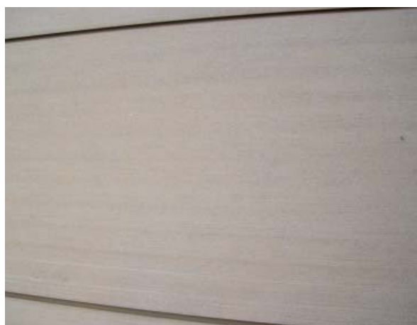
Stav povrchu terasy po očištění tlakovou vodou a po vyschnutí.
