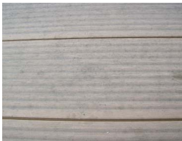
Stav povrchu dlouhodobě neudržované terasy.
